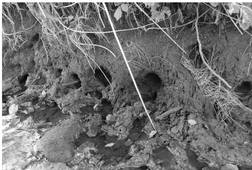
Abbildung 1: Von Signalkrebsen unterminiertes Bachufer bei Niedrigwasser.
