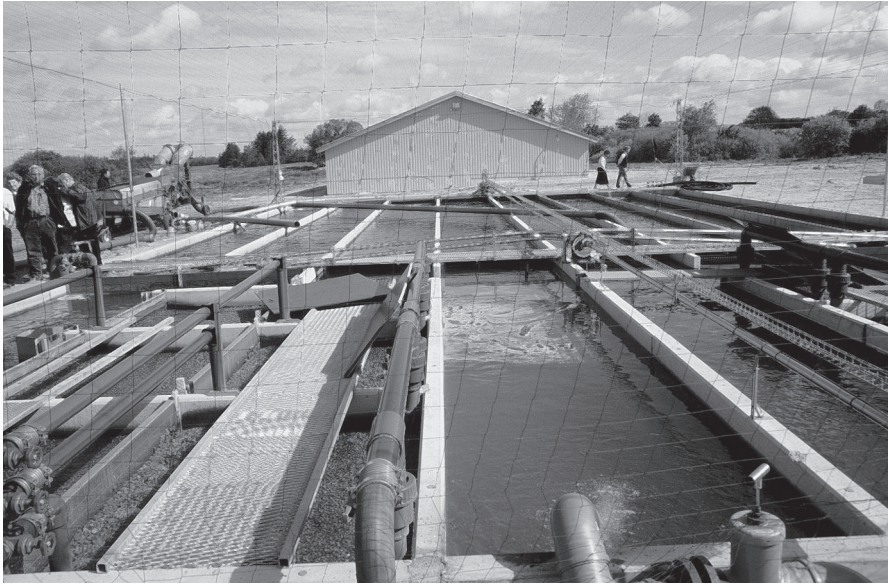
Foto 1: Vorstreckanlage im Kreislauf, links vorne der Biofilter. Foto: Roland Rösch
